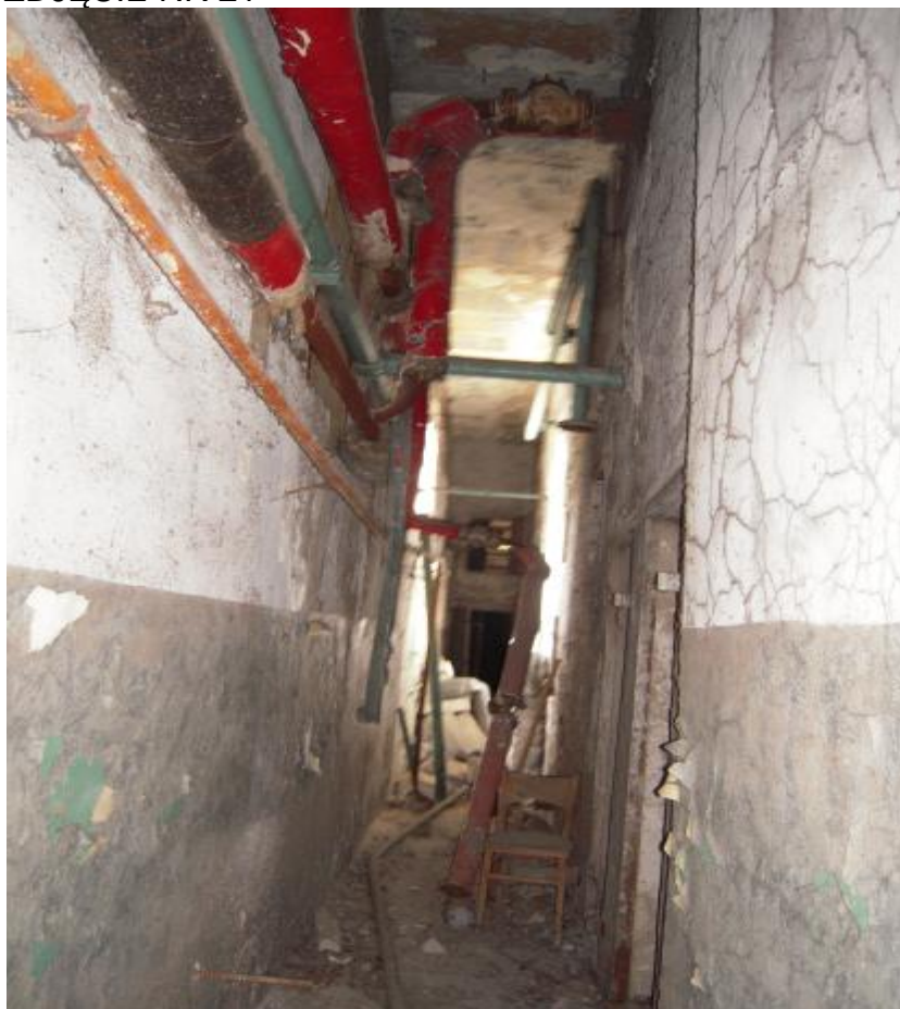
KORYTARZ TECHNICZNY I PIĘTRO BUDYNEK NR 9
