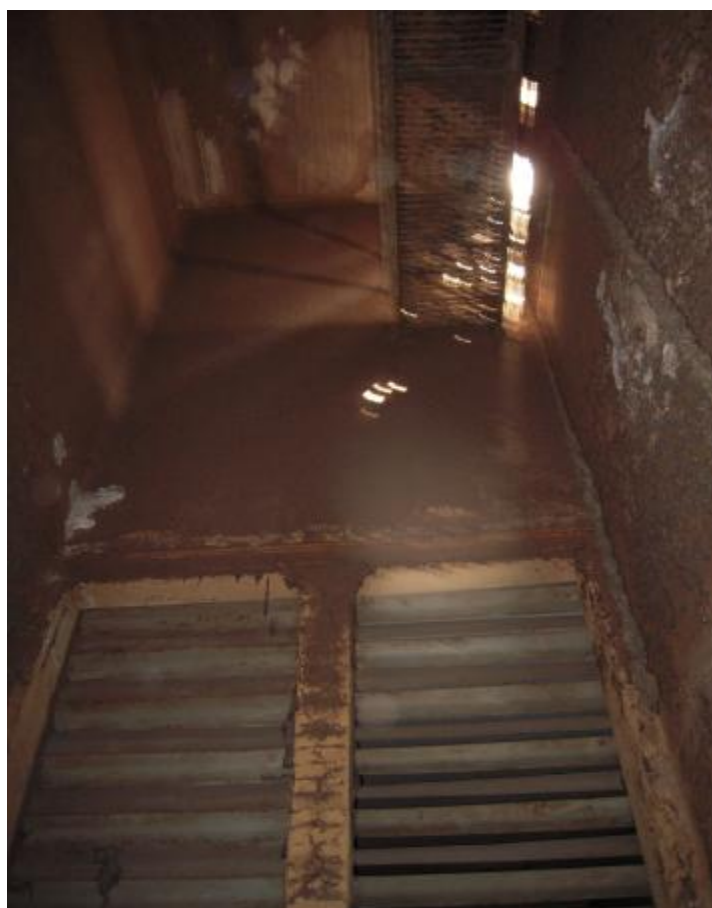
WNĘTRZE CZERPNI POWIETRZA (WIEŻA) BUDYNEK NR 9
