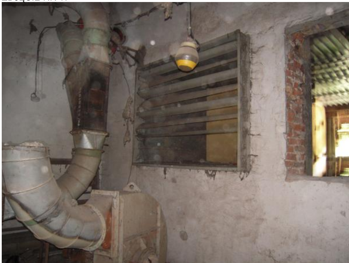
URZĄDZENIA WENTYLACYJNE NA I PIĘTRZE BUDYNEK NR 9
